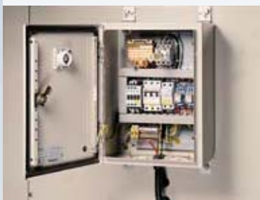
Cuadro eléctrico independiente e integrado.
